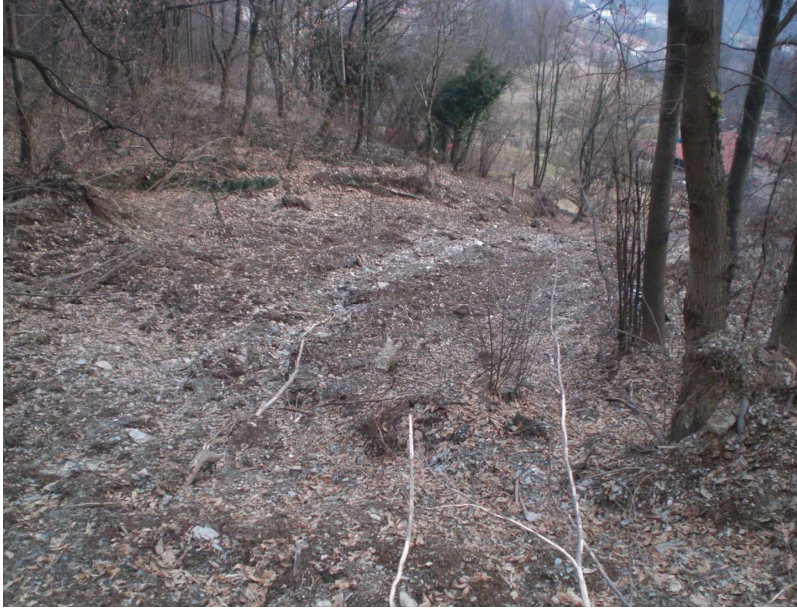
Foto 2. Il versante a valle della strada, lungo il quale ruscellano le acque che interessano l'abitato di contrada Sorgati.
