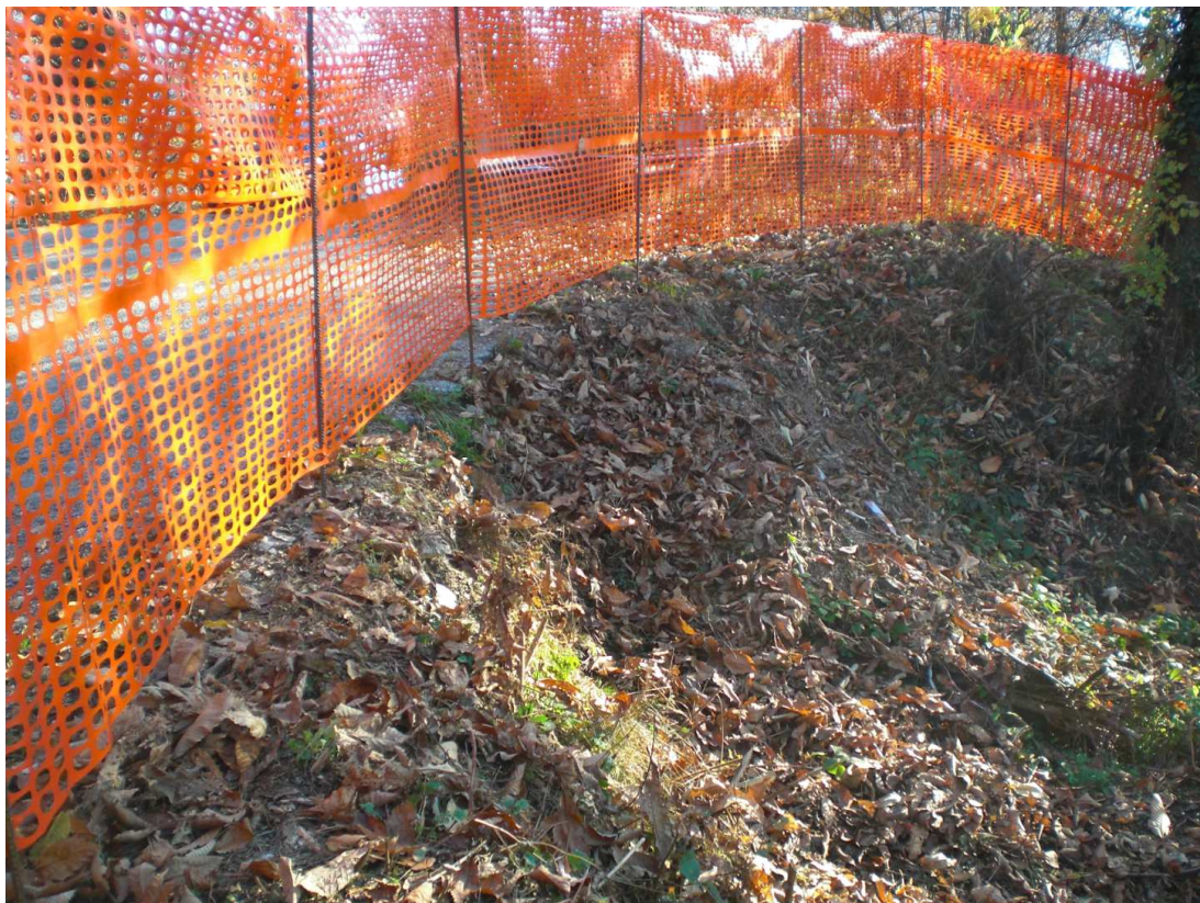
Foto 3. La nicchia in cui si evidenzia il cedimento del versante (Zavino dopo Sorgati – tratto Est).
