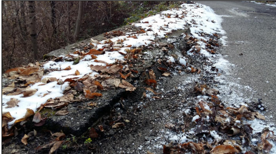
Foto n. 10 - Tratto 3 - particolare dell'abbassamento del sedime stradale a monte del cordolo
