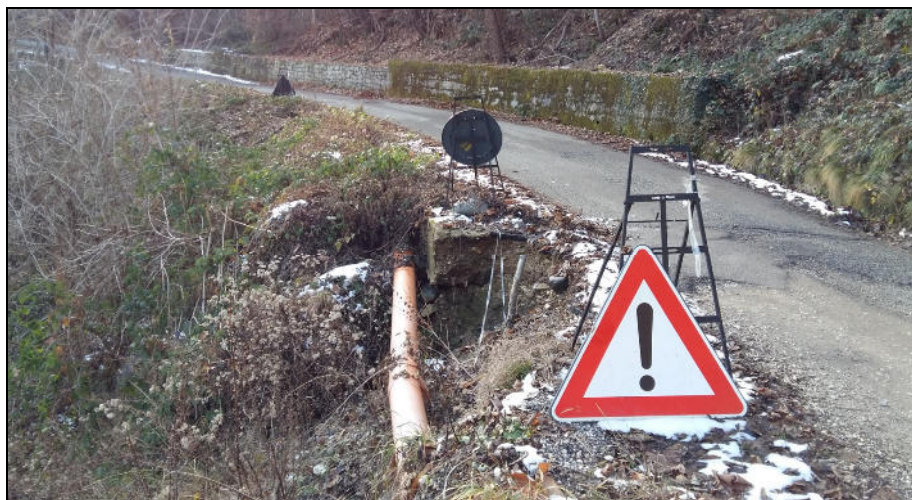
Foto n. 6 - Tratto 2 - particolare da nord del tratto di strada interessato dal crollo
