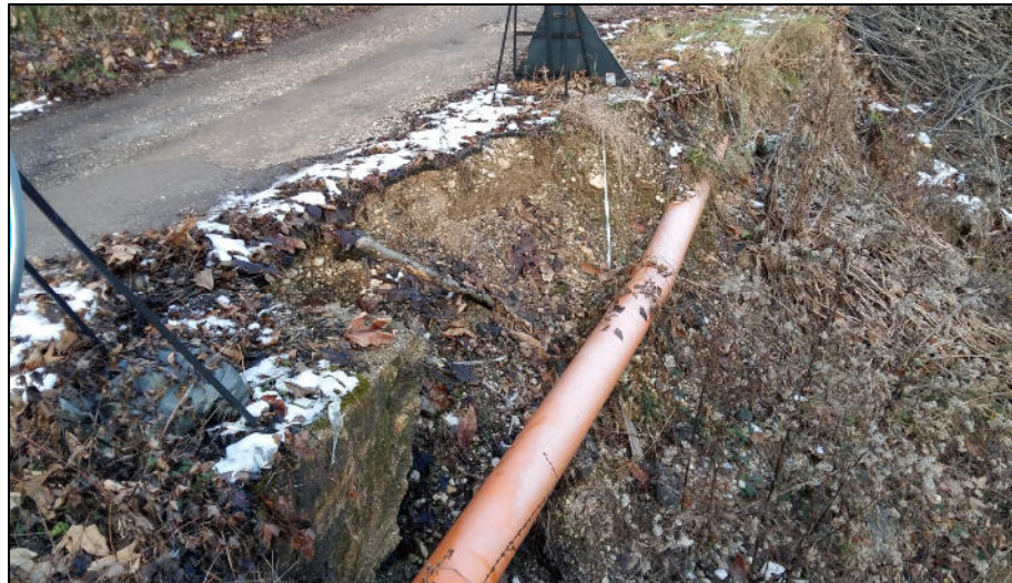
Foto n. 5 - Tratto 2 - particolare da sud del tratto di strada interessato dal crollo
