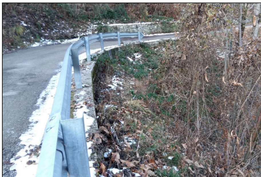
Foto n. 9 - Tratto 3 - particolare del cordolo lesionato
