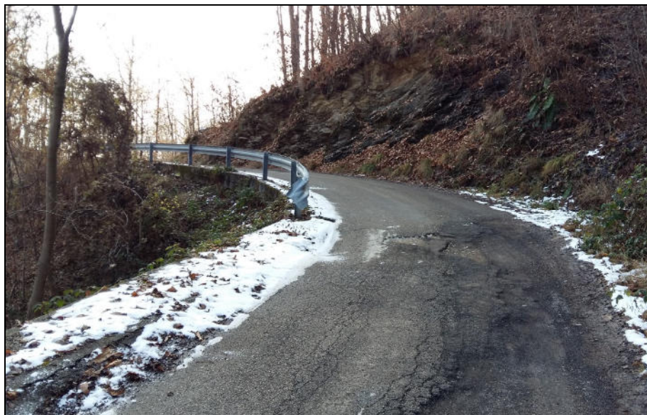
Foto n. 8 - Tratto 3 - vista da nord del tratto di strada maggiormente lesionato
