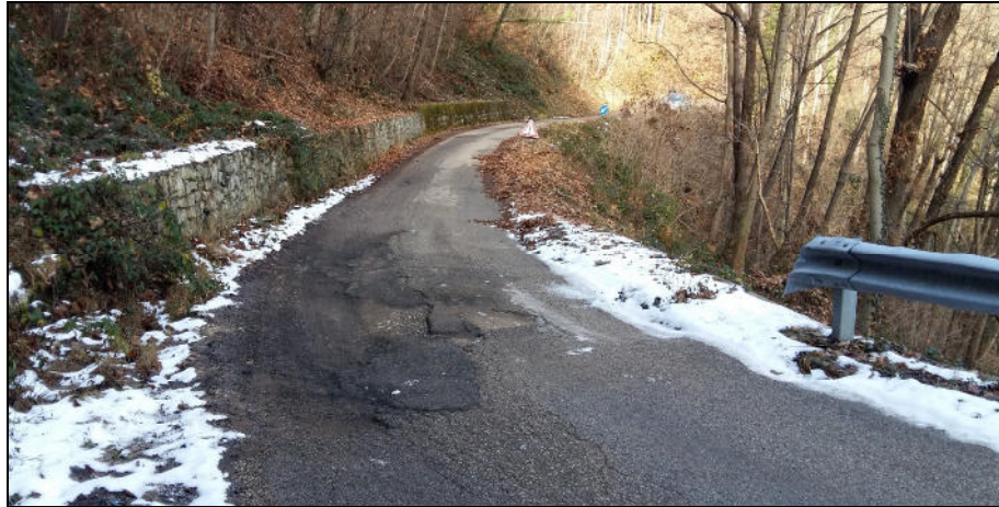
Foto n. 7 - Tratto 3 - vista da sud del tratto di strada maggiormente lesionato
