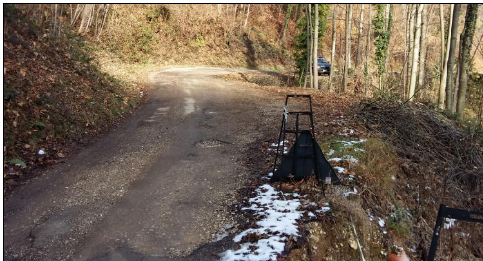
Foto 1 - Tratto 1 - panoramica da sud del tratto di strada sostenuto dalle gabbionate lesionate
