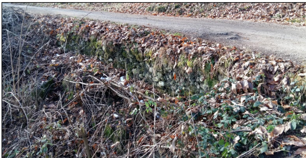
Foto n. 2 - Tratto 1 - particolare del tratto di strada sostenuto dalle gabbionate lesionate da consolidare
