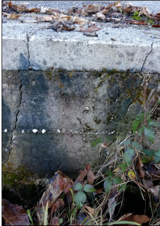
Foto n. 12 - Tratto 3 - particolare di alcune delle lesioni che interessano il cordolo.
