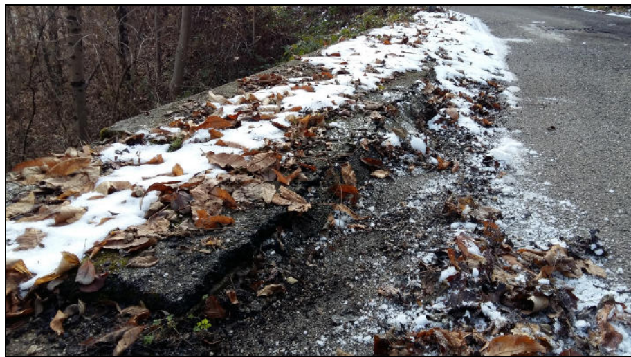
Tratto 3 - particolare dell'abbassamento del sedime stradale a monte del cordolo
