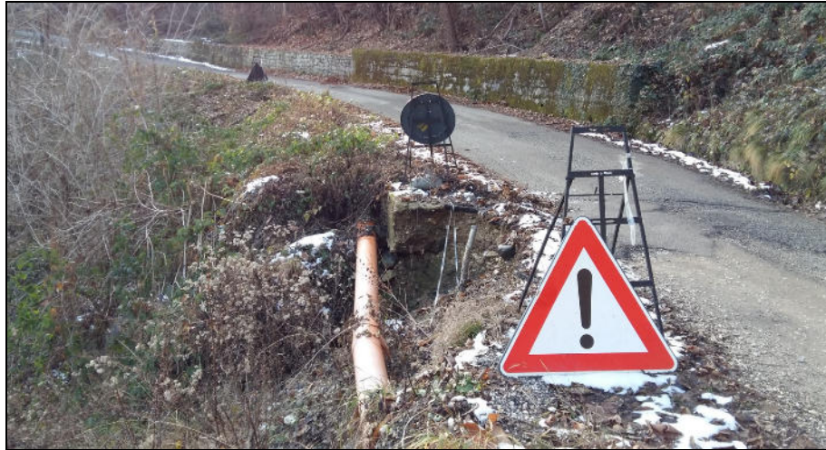
Tratto 2 - particolare da nord del tratto di strada interessato dal crollo
