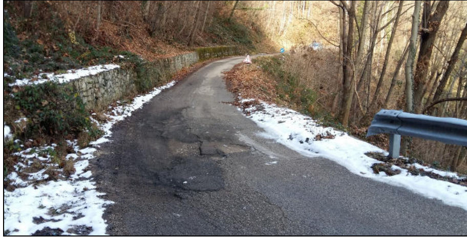
Tratto 3 - vista da sud del tratto di strada maggiormente lesionato
