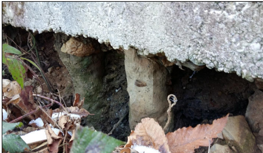
Tratto 3 - particolare del versante a valle della strada; l'abbassamento del terreno ha messo a nudo le fondazioni su pali del cordolo.
