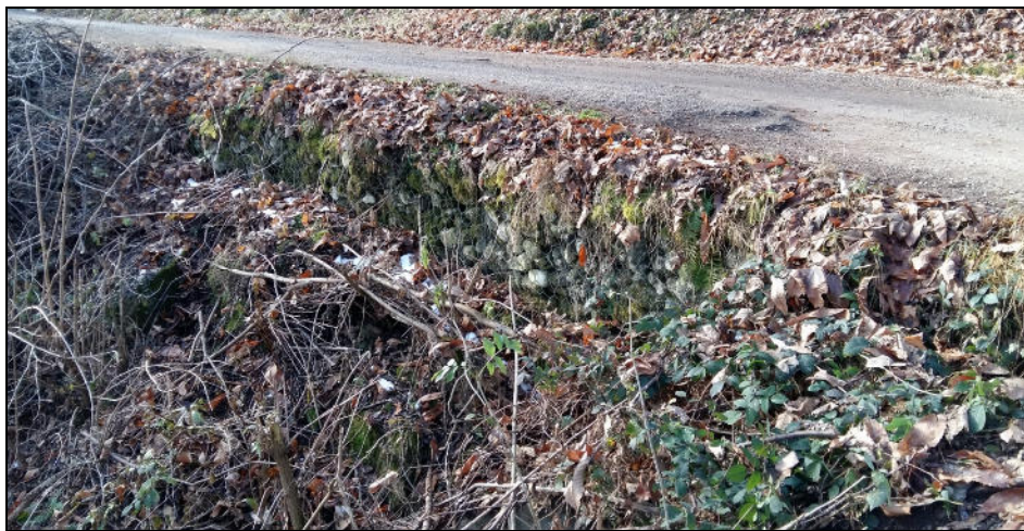
Tratto 1 - particolare del tratto di strada sostenuto dalle gabbionate lesionate da consolidare
